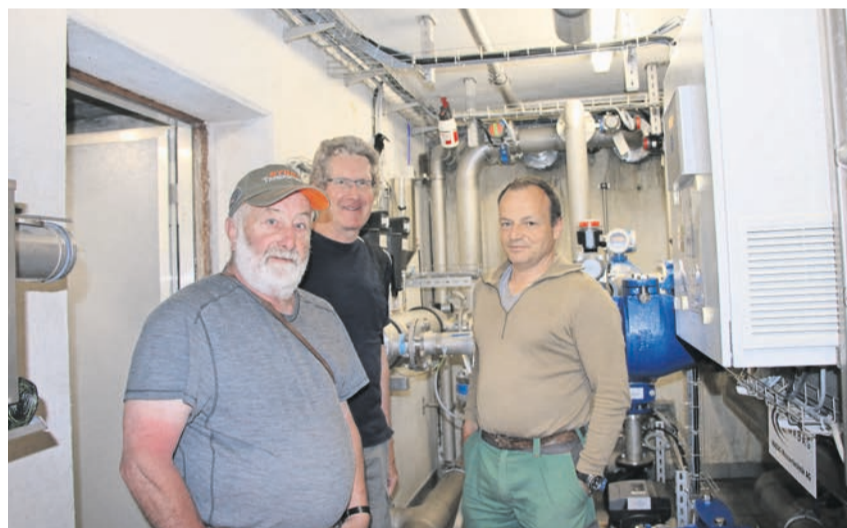
Hansruedi Herger, ehemaliger Brunnenmeister, Heiri Arnold, Präsident Wasserversorgung, und Fredi Gisler, stellvertretender Brunnenmeister (von links), im Technikraum des Reservoirs.
